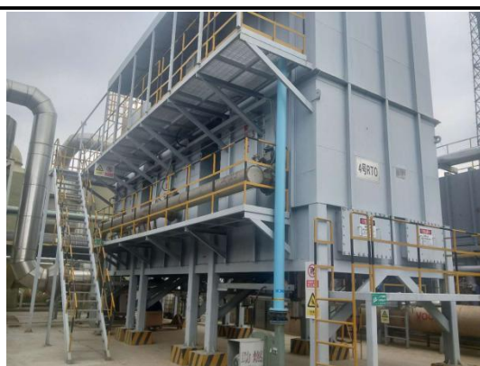
RTO 焚烧装置
