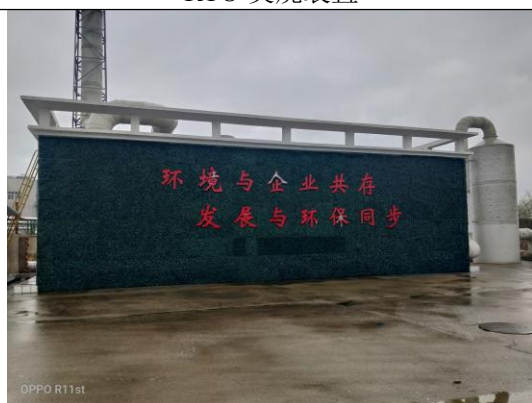
一级水洗+生物除臭装置（乐果 3 号车间原粉离心和干燥车间无组织尾气收集）
