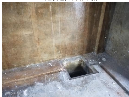
210 危废仓库导流沟及收集池
