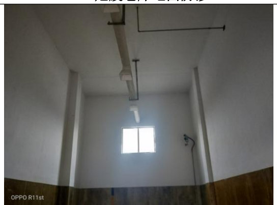
210 危废仓库废气收集装置
